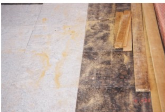
Foto 107 - Restos de madeira e pó de madeira sobre piso de granito (risco de manchamento após contato com água).
