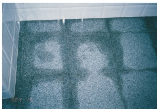
Foto 52 - Escurecimento por umidade em granito, nas adjacências das juntas.
