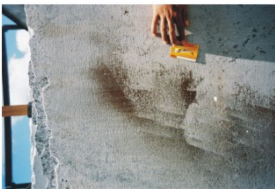
Foto 102 - Presença de incrustações de granalha no verso de chapas de rocha (possível fonte de oxidação).
