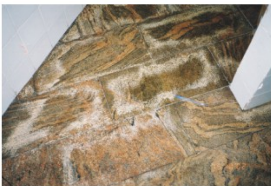
Foto 95 - Exemplo de piso em granito, com patologia de escamação superficial causada por umidade ascendente.
