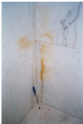
Foto 68 - Detalhe de piso e parede manchados devido à presença de impurezas na areia da argamassa de fixação.
